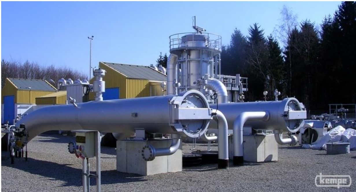
Abbildung 29: Pipeline Molchschleuse (Quelle: Fa. Kempe)
